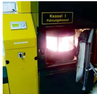
Führungskessel einer Pelletsanlage der Wohnungsgenossenschaft „Kontakt“ in Leipzig.
